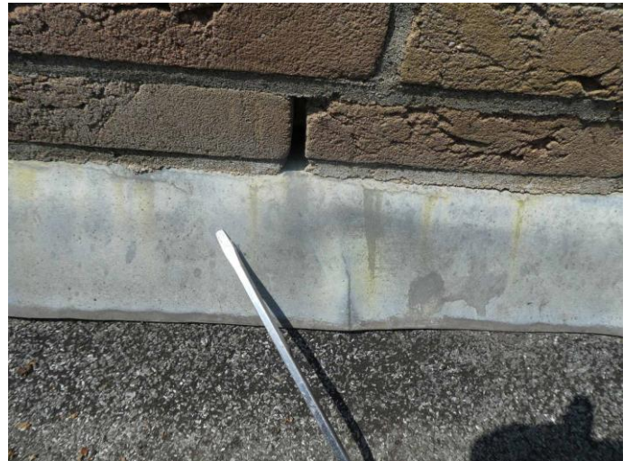
Figuur 12: Open stootvoeg vlak boven het bitumen dak
