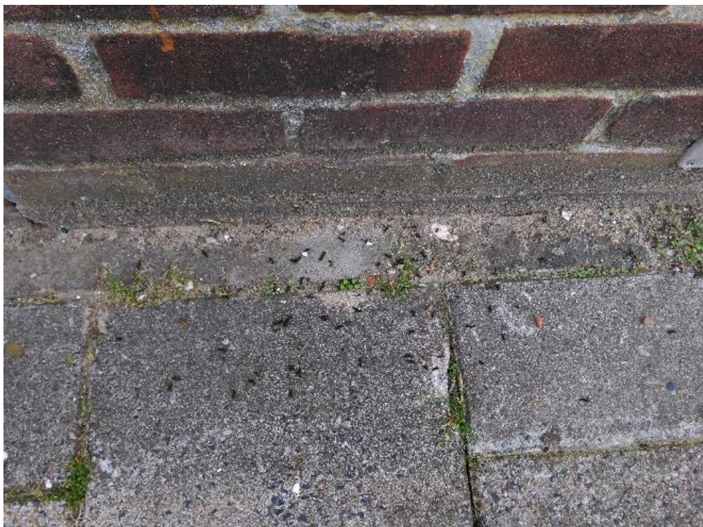
Figuur 10. Uitwerpselen van vleermuizen aan de voet van een gevel van de woning aan de Prins Bernhardstraat 103.
