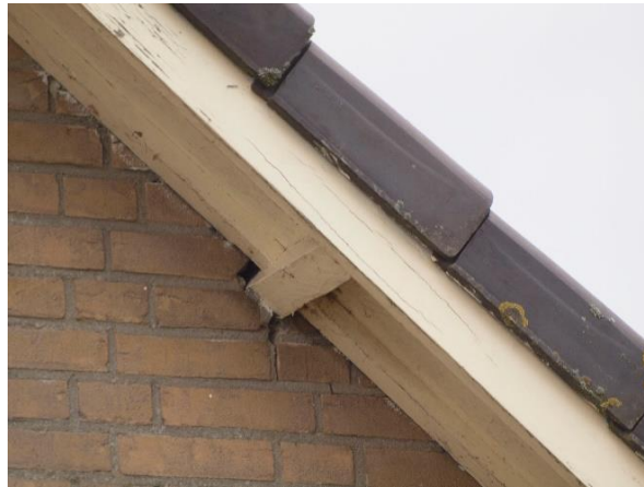
Figuur 12. Opening tussen de draagbalk van het dak en de muur.
