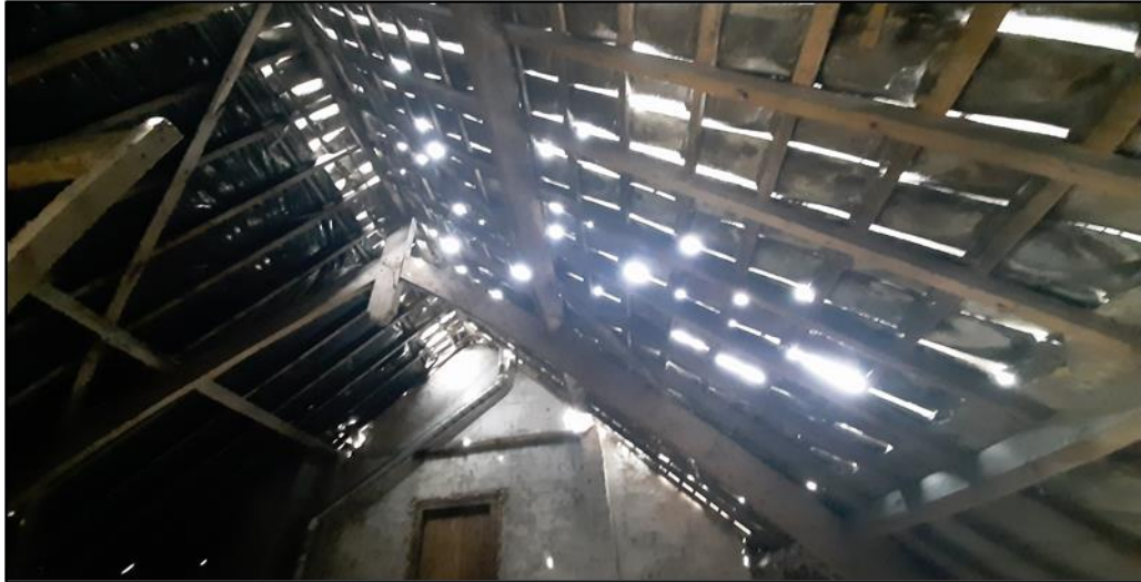
Figuur 4 De binnenzijde van het pand. Delen dakbeschot zijn niet meer aanwezig. Aan de onderzijde van het dak is één rij met beplating aanwezig, in de vorm van een enkelvoudig multiplex plaat (rechts zichtbaar).
