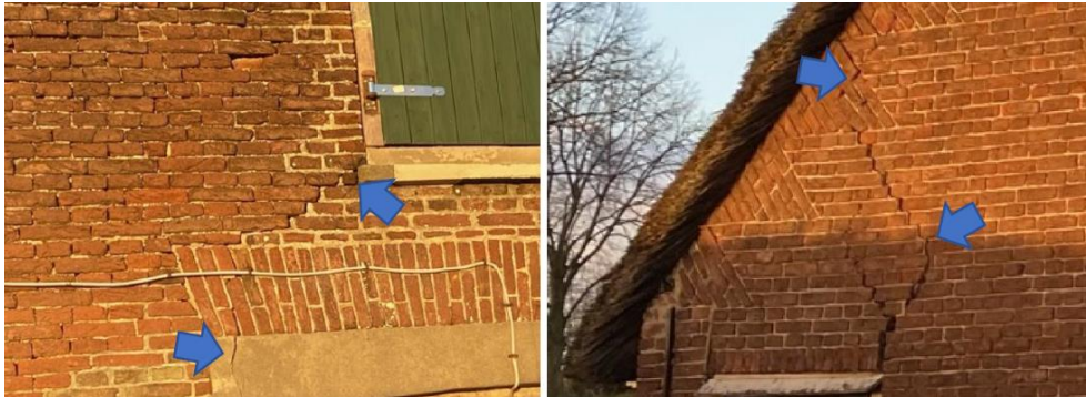
Afbeelding 5: Scheurvorming zuidgevel achterhuis boerderij
