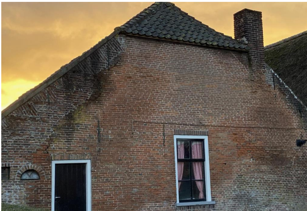
Afbeelding 7: Waterschade aan de voorgevel bijgebouw
