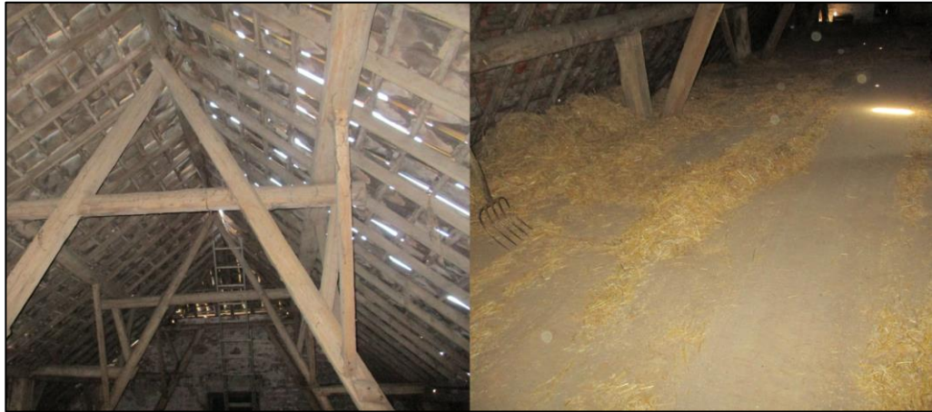
Figuur 3 De daken van de stallen zijn in een erbarmelijke staat waardoor er sprake is van tochtwerking (links) daarnaast zijn er geen sporen aanwezig als uitwerpselen en prooiresten (rechts). Derhalve kan de aanwezigheid van grootoorvleermuizen uitgesloten worden.
