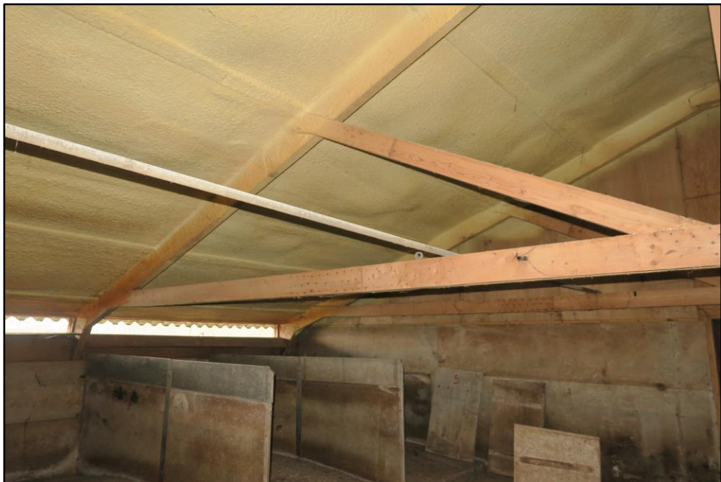
Figuur 4 In de stallen 1, 5 en een gedeelte van stal 7 is isolatiemateriaal tegen de onderzijde van het dak gespoten.
