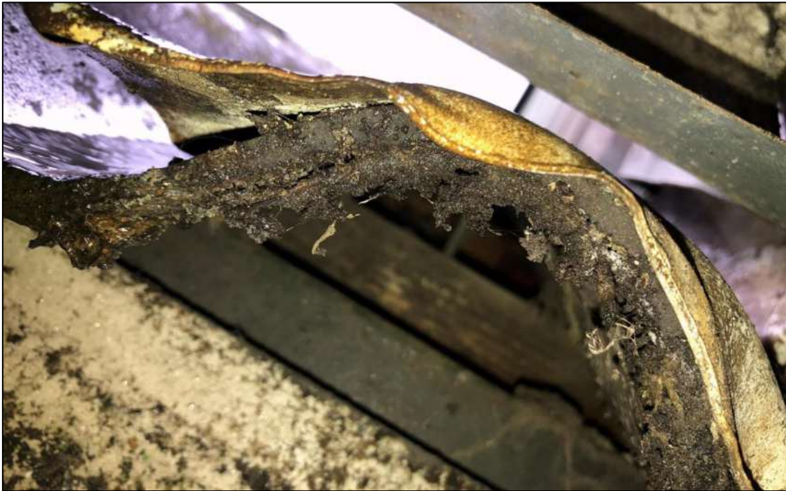
Figuur 11: Huismussen kunnen via de dakgoot tussen de dakplaten en het dakbeschot komen en daar broeden.
