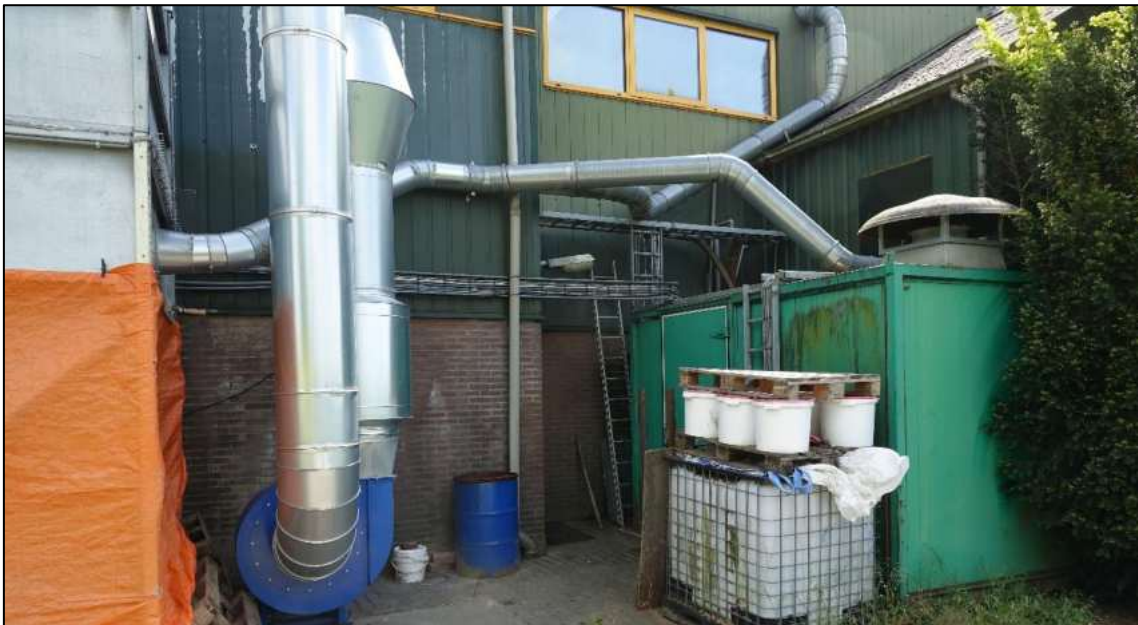
Figuur 12: Langs de westelijke gevel staat afzuigapparatuur opgesteld. Entreepunten van de buizen naar de binnenruimte zijn goed afgesloten.
