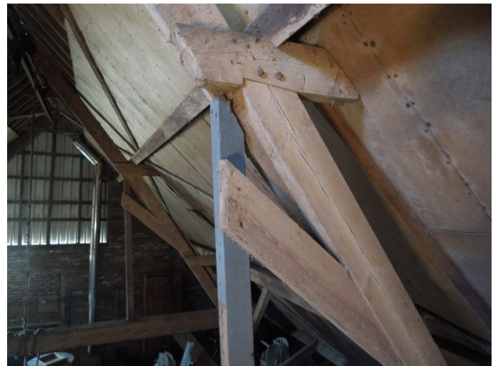
54. De spantbalken en korbelen van de achterste twee driehoekspanten zijn doorgezaagd.
