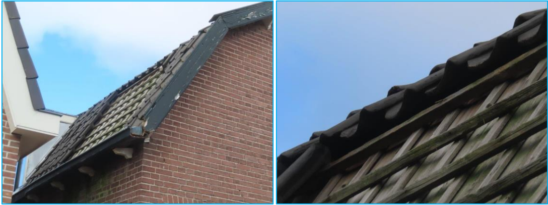
Foto's: Deel waar dakpannen verdwenen zijn biedt mogelijk toegang tot woning.
