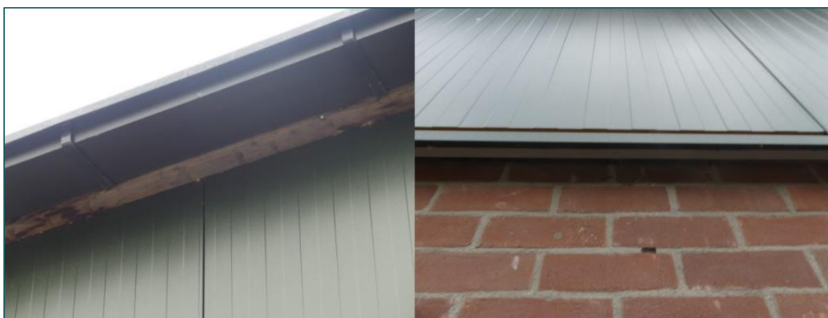
Figuur 3.1 Houten lat geplaatst onder dakgoot waardoor er geen opening aanwezig is (links). Kunststof gevelbekleding sluit aan op bakstenen muur, waardoor er geen mogelijkheid is tot invliegen voor vleermuizen (rechts)
