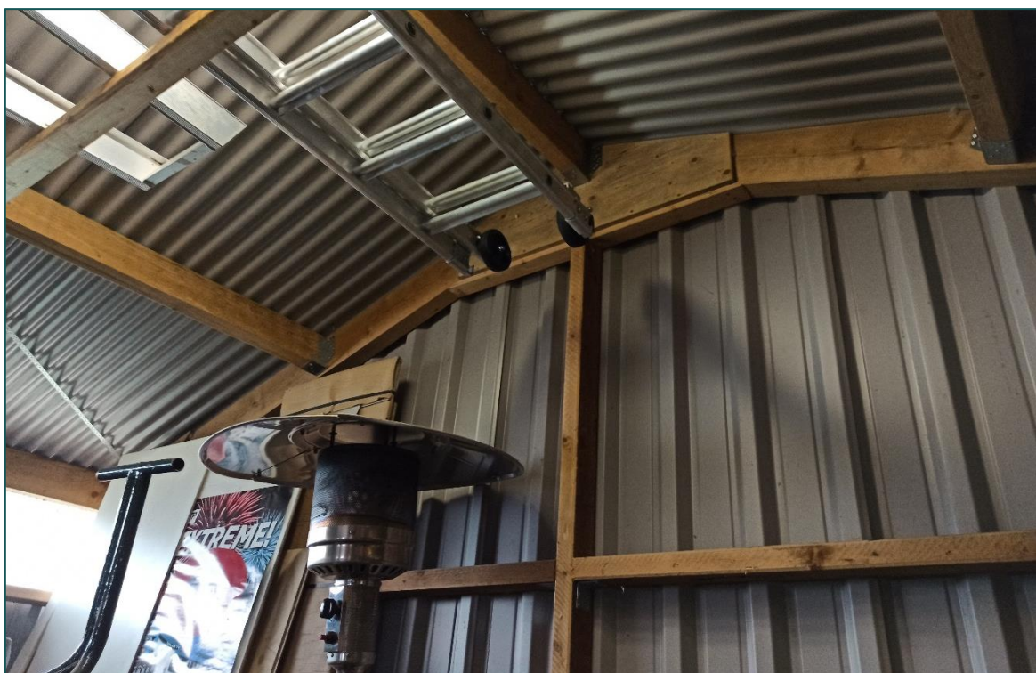
Figuur 2 De bebouwing bestaat uit damwandplaten met een golfplaten dak. Er is geen spouw of dakbeschot aanwezig.
