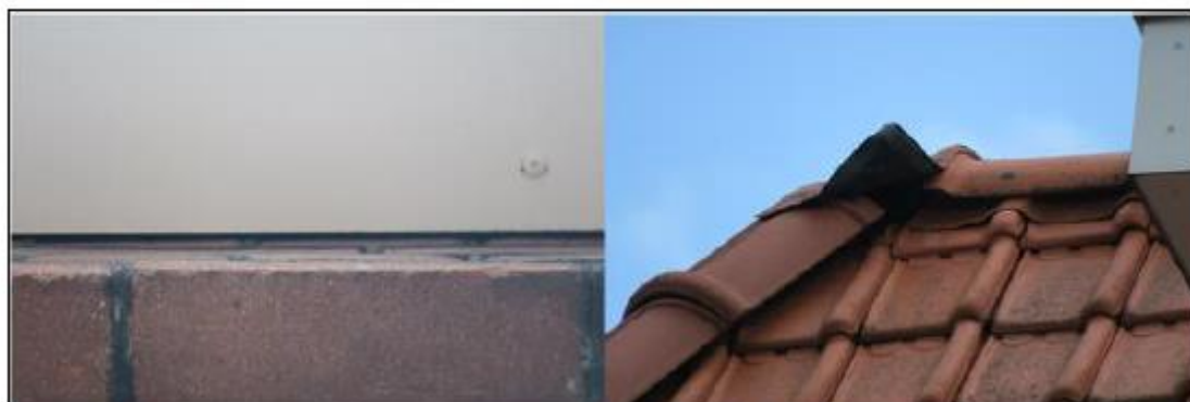
Figuur 4 De opening tussen de houten daklijst en de muur (links) en de loodflap die niet goed aansluit op de dakpannen (rechts) aan de Vlietskant 24.
