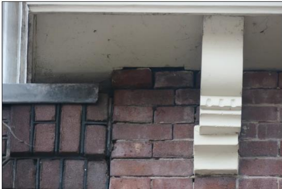
Figuur 3 De opening tussen de houten daklijst en de muur aan de Vlietskant 12.
