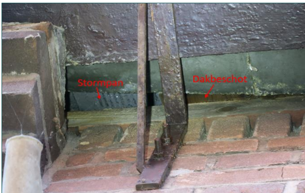
Figuur 3.3 Onder het dak is geen ruimte voor huismussen om te kunnen nesten. De stormpannen zijn direct geplaatst op het dakbeschot waardoor er geen ruimte onder het dak aanwezig is.
