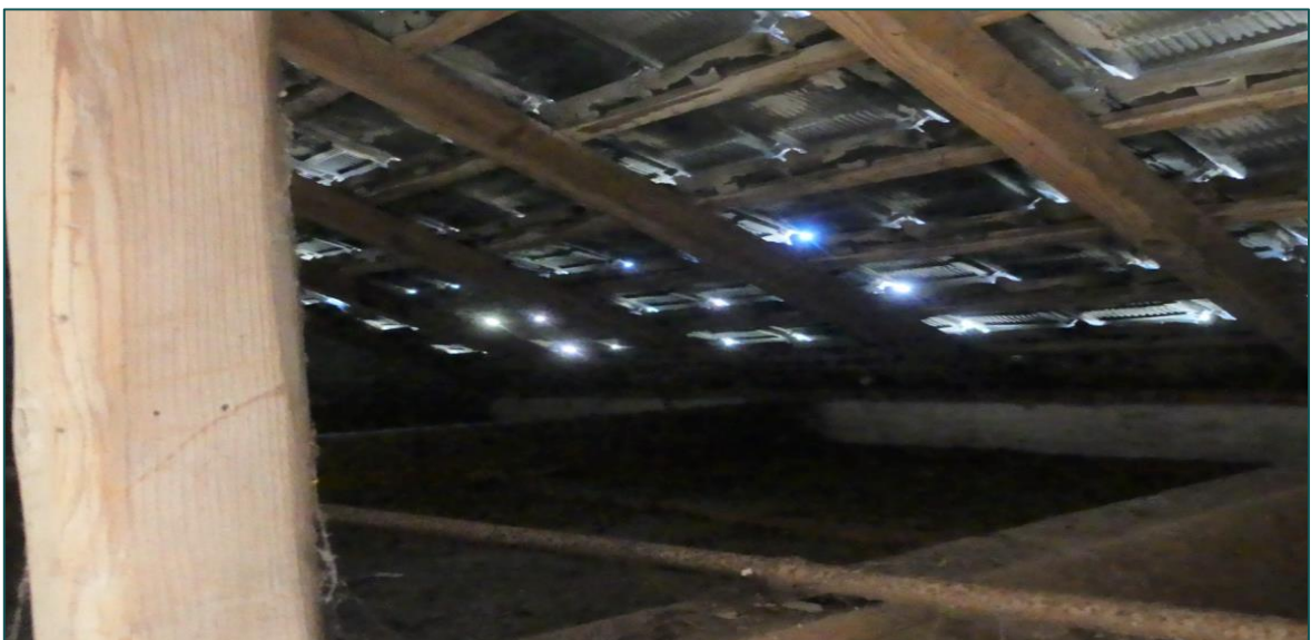
Figuur 3.2 In schuur C ontbreekt het dakbeschoot. Er zijn veel openingen en kieren tussen de dakpannen. Echter zijn er geen wegkruipruimtes en zorgt regen en de wind voor een vochtig en wisselvallig binnenklimaat.
