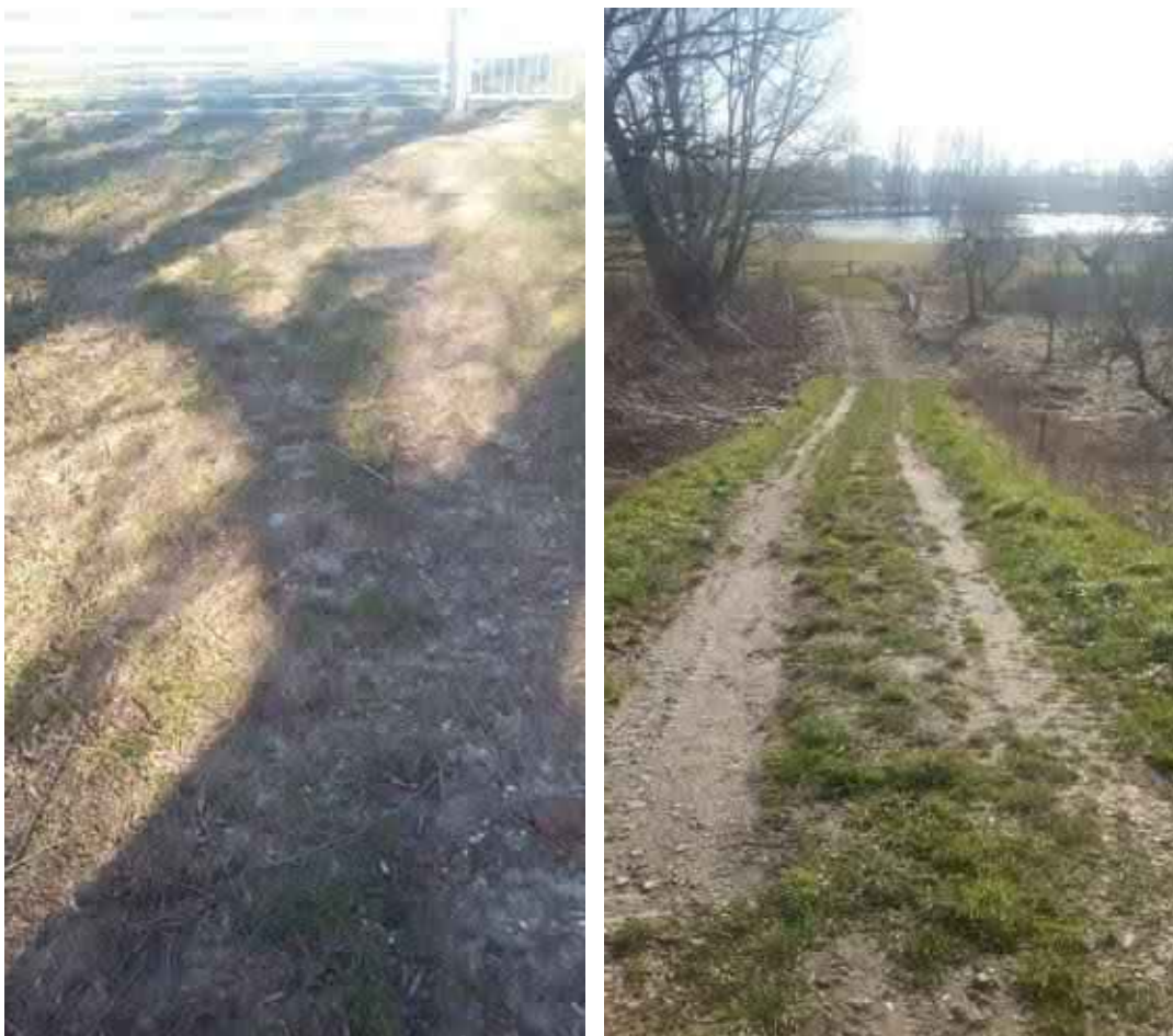
Afbeelding 4.1: Foto's opritten van en naar de dijk. Aanwezigheid puin (asbestverdacht)
