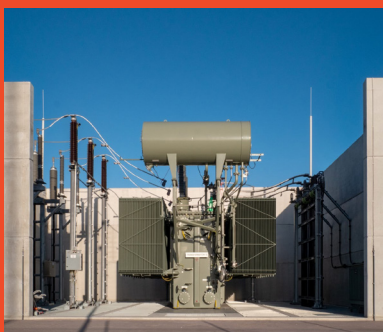
Foto transformator in transformatorruimte zonder dak.
