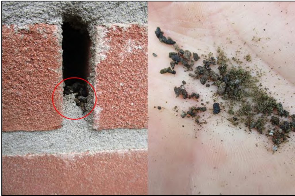
Figuur 5 Uitwerpselen van vleermuizen in de stootvoegen van het regelstation.
