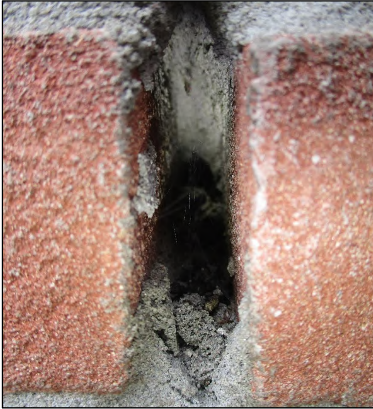
Figuur 3 Open stootvoeg met uitwerpselen van vleermuizen in het regelstation op de planlocatie.
