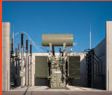
Foto transformator in transformatorruimte zonder dak.
