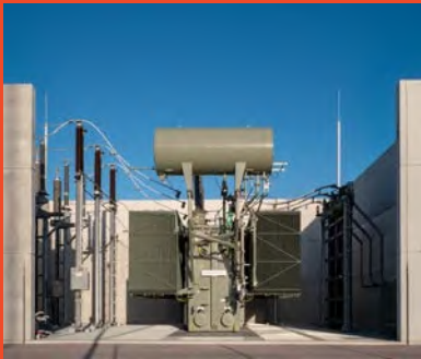
Foto transformator in transformatorruimte zonder dak.
