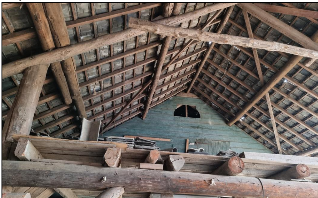
Figuur 4 Zichtbaar afwezig dakbeschot waardoor er geen ruimte aanwezig is voor gebouwbewonende vleermuizen.
