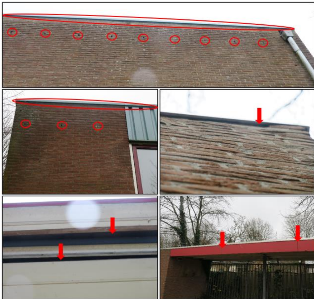
Figuur 1.3 Middels kierende daklijsten, open stootvoegen en kieren in het dak overstek en tussen trespaplaten kunnen vleermuizen toegang krijgen tot binnenruimtes waardoor potentie voor vleermuizen niet uitgesloten kan worden.
