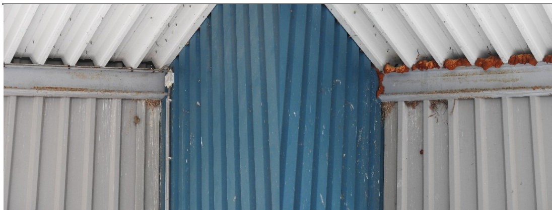
Figuur 3.3 Enkele van de aangetroffen nesten van huismus in de overkapping (nummer 1)
