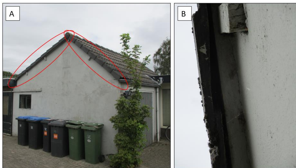
Figuur 5 De zuidwest zijde van de schuur. (A) de kantpannen waaronder een kier aanwezig is zijn met rood omcirkeld. (B) een close-up foto van de kieren onder de kantpannen.
