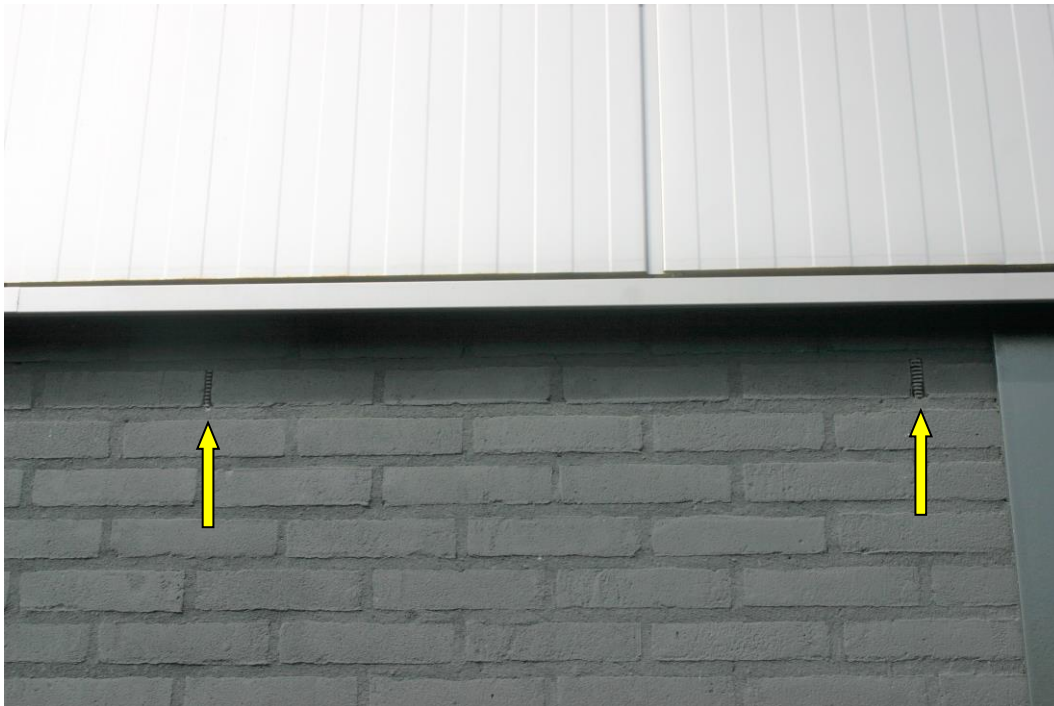
Figuur 4.4.1. De open stootvoegen in de gevels van de loods zijn niet toegankelijk voor vleermuizen.
