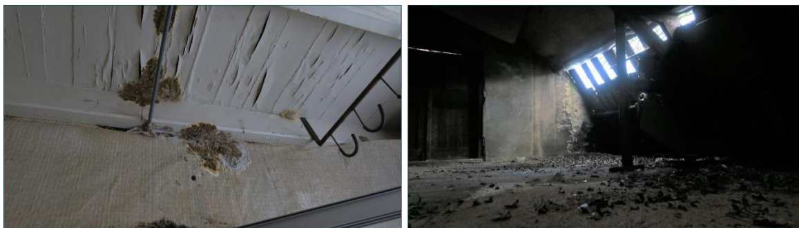
Figuur 3.1 Wegens de grote openingen in het dak is er sprake van tochtstrooming, te zien aan de bladeren op de grond. Daarnaast is er sprake van extreme schimmelgroei.
