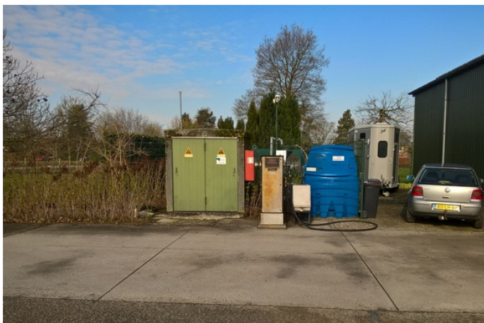
Foto 5: terreindeel bovengrondse dieselolie-installatie
