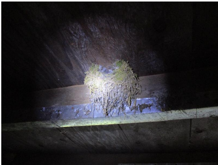
Figuur 3 In de voormalige veestal ontbreken er isolatieplaten. Hierdoor zijn er geen nestlocaties mogelijk van huismussen.
