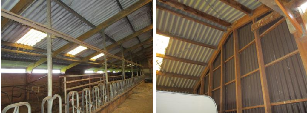
Figuur 2 In de voormalige veestal (links) en loods (rechts) ontbreken er isolatieplaten. Hierdoor zijn er geen nestlocaties mogelijk van huismussen.
