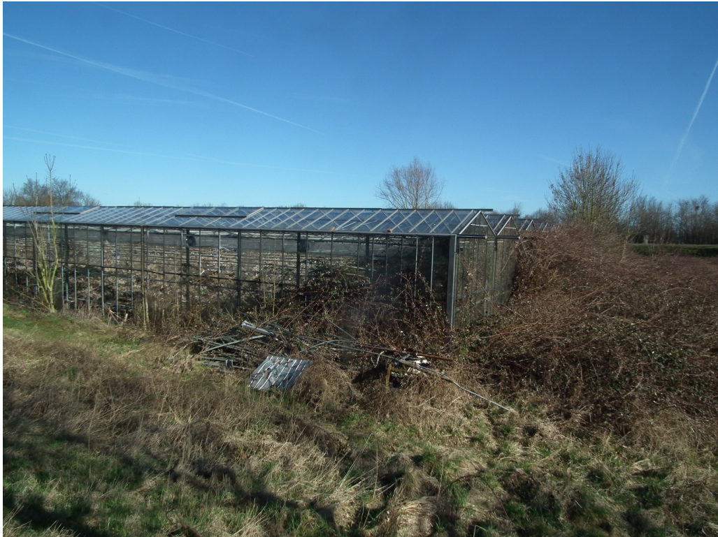
Figuur 3 De kas verkeerd in een matig tot slechte conditie. Een deel van de ruiten zijn kapot of ingegoooid.
