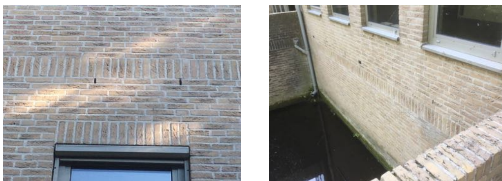
Figuur 11. Open stootvoegen in de gevel van de zuidoosthoek (l) en de noordgevel (r).
