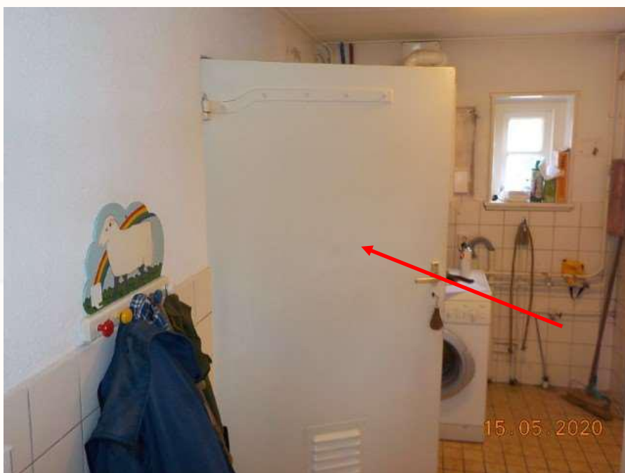
Foto 6: Bron B02, asbesthoudende plaat op deur naar voormalige stal
