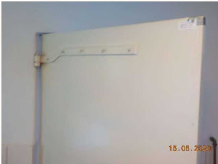
Foto 7: Bron B02, asbesthoudende plaat op deur naar voormalige stal
