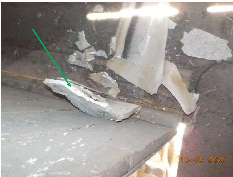
Foto 13: Bron B05, asbestvrije beplating achter zolder luik, voormalige stal
