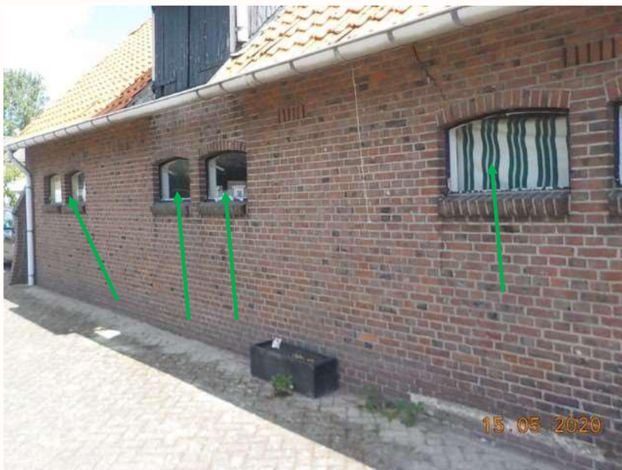
Foto 9: Bron B03, asbestvrije kit stalen ramen
