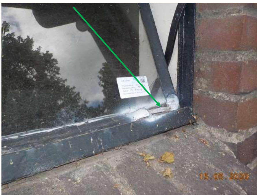
Foto 10: Bron B03, asbestvrije kit stalen ramen
