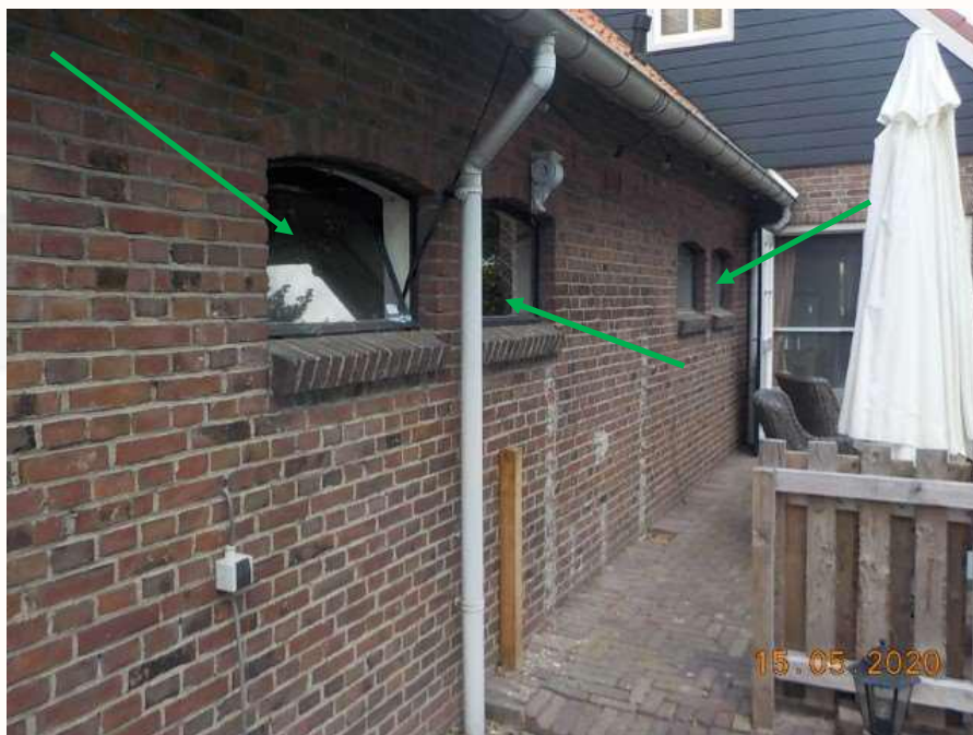
Foto 8: Bron B03, asbestvrije kit stalen ramen
