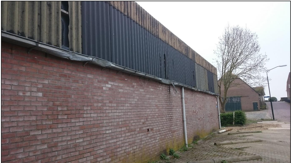
Figuur 2 De westzijde van het gebouw met enkele gaten in de wand
