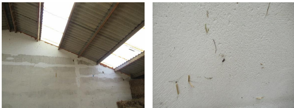
Figuur 4.4. Mogelijke locatie vleermuisverblijf en vleermuiskeutel tegen de muur op deze locatie.
