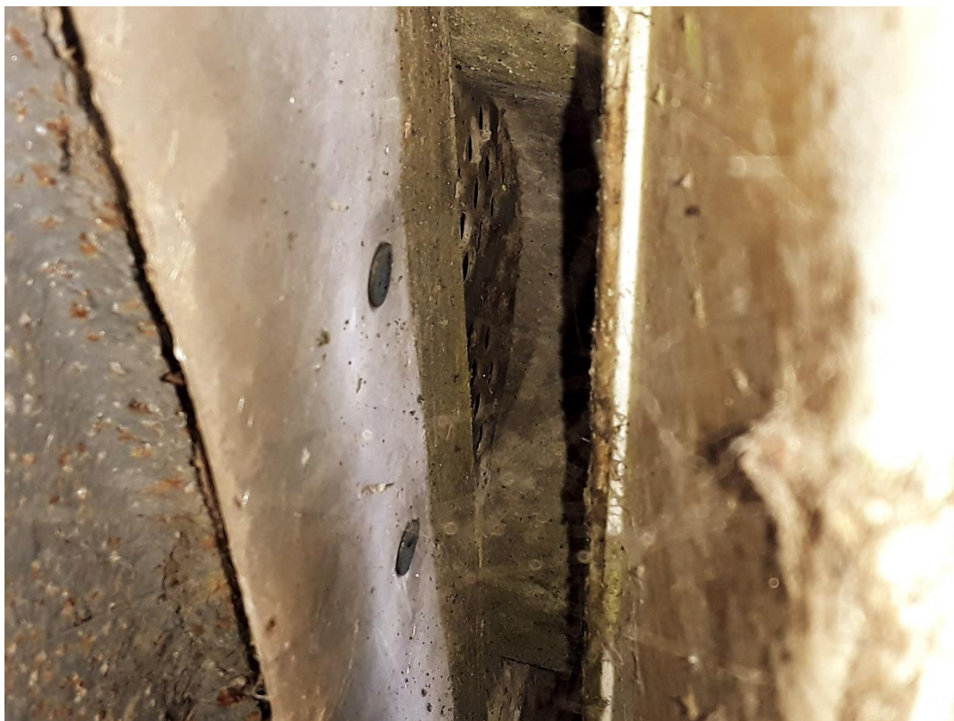
Figuur 5 Ruimte onder dakpannen niet toegankelijk door aanwezigheid roosters.
