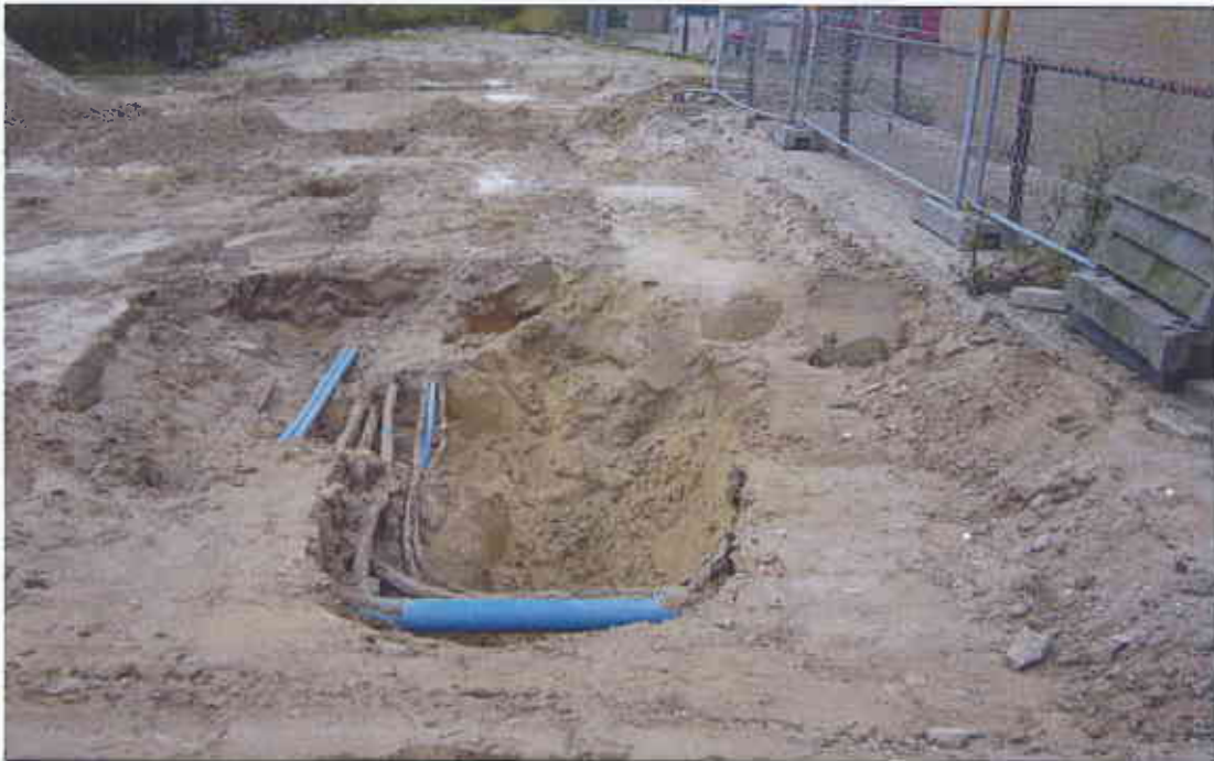
Leidingtracé ter plaatse van vak C westzijde terrein (PAK-verontreiniging)
