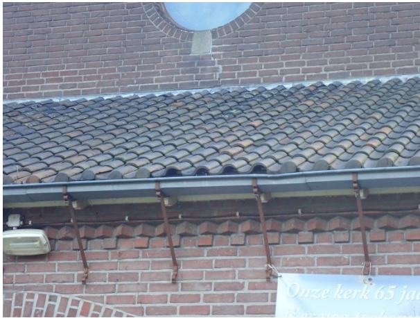
Foto 5: links, pannendak kerk met verdwenen onderpannen Foto 6: rechts, holte in de plantaan ten noorden van de kerk
