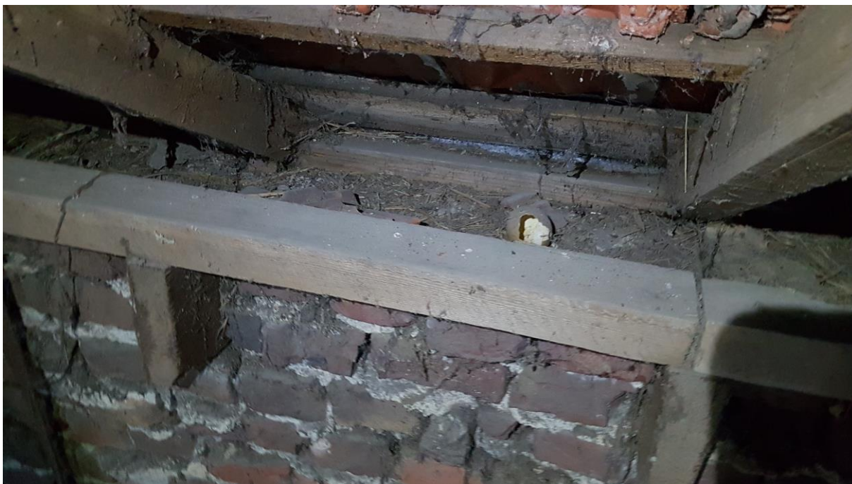
Foto 3: een oud kippen ei op de muurplaat. Waarschijnlijk hierheen gebracht door een kleine marterachtigen
