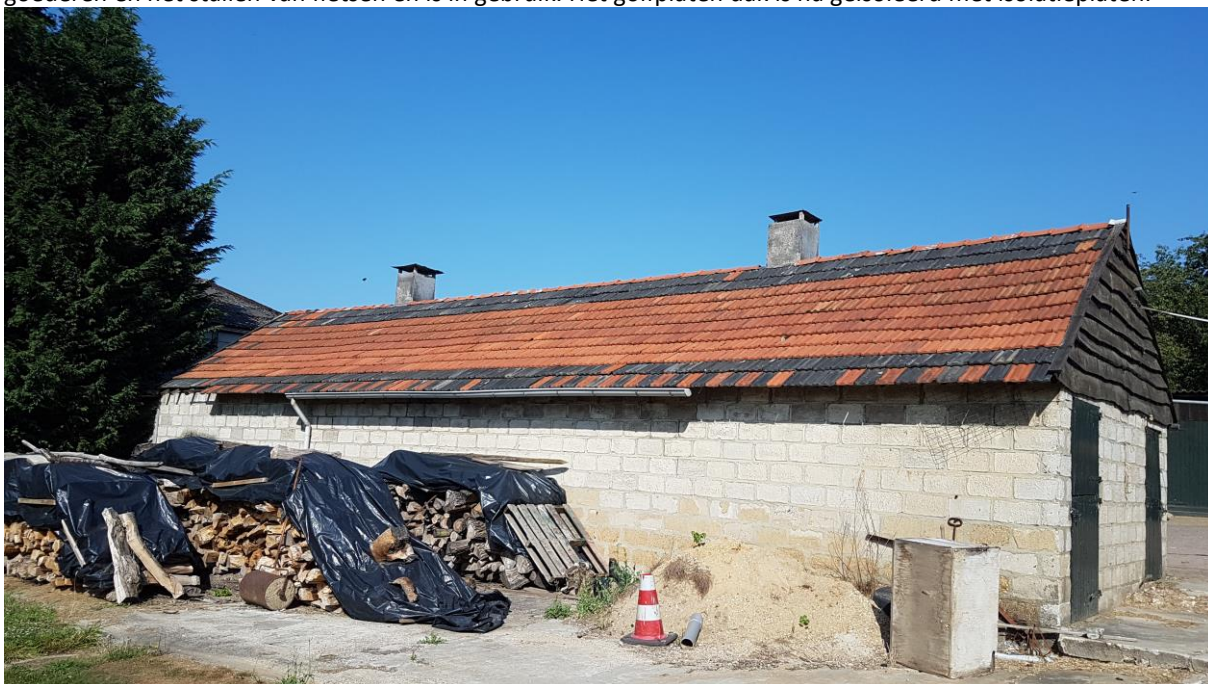
Foto 8: de zuidoostelijke zijde van de oude stal. De dakrand bij de gevel plaat was veelal afgewerkt met plaat materiaal maar bij enkele stukken ontbrak deze afwerking. Aan de noordwestelijke zijde was deze wel volledig.
