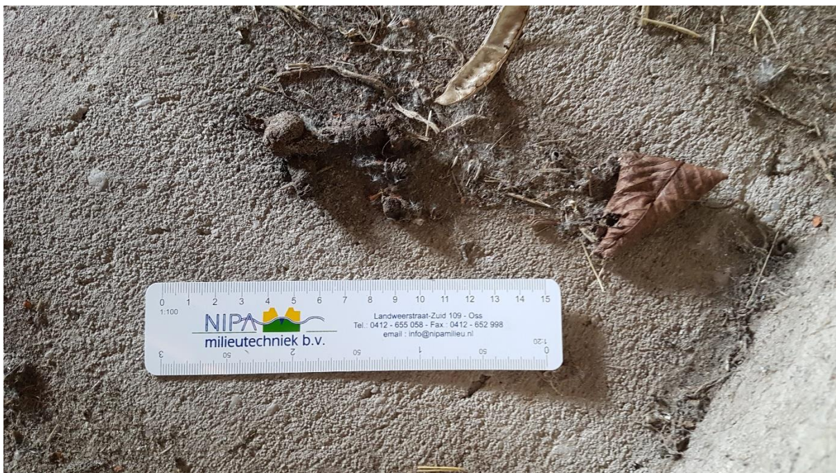
Foto 5: fecaliën van vermoedelijk de bunzing aangetroffen op de zolder van de oude aangebouwde schuur..
