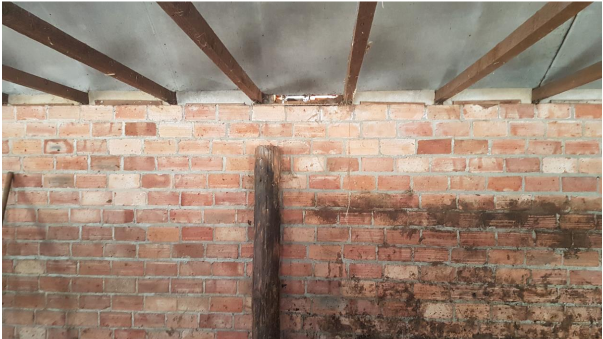
Foto 14: ontbrekende stukken van de afwerking bij de muurplaat van de oude stal.
