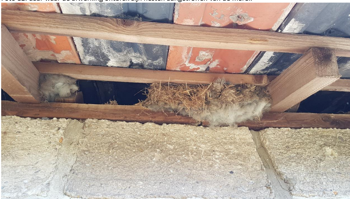
Foto 13: een nest van vermoedelijk de huismus op de muurplaat van de oude stal.
