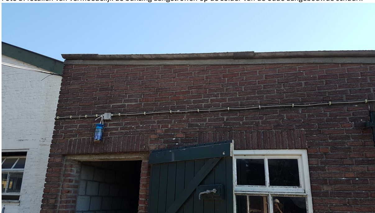
Foto 6: de nieuwere aangebouwde schuur. De gevel is nog gaaf en de dakrand en gevel is zonder kieren afgewerkt met cement.
