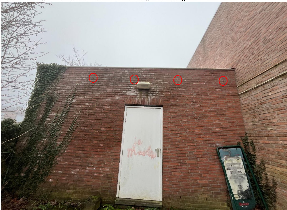
Foto 4: De open stootvoegen in de meest noordelijke lage aanbouw.
