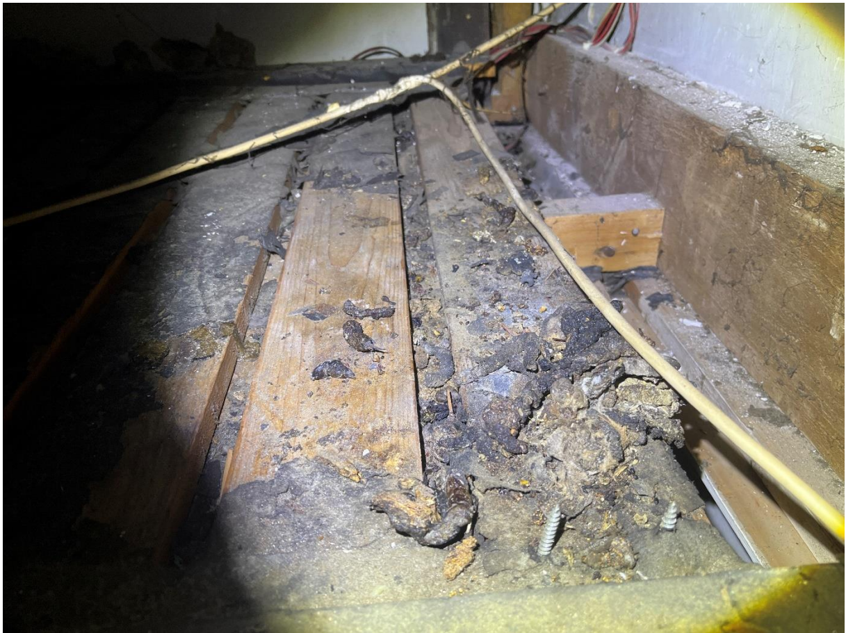
Foto 7: Steenmarterfecaliën op de zolder van het dorpshuis.
