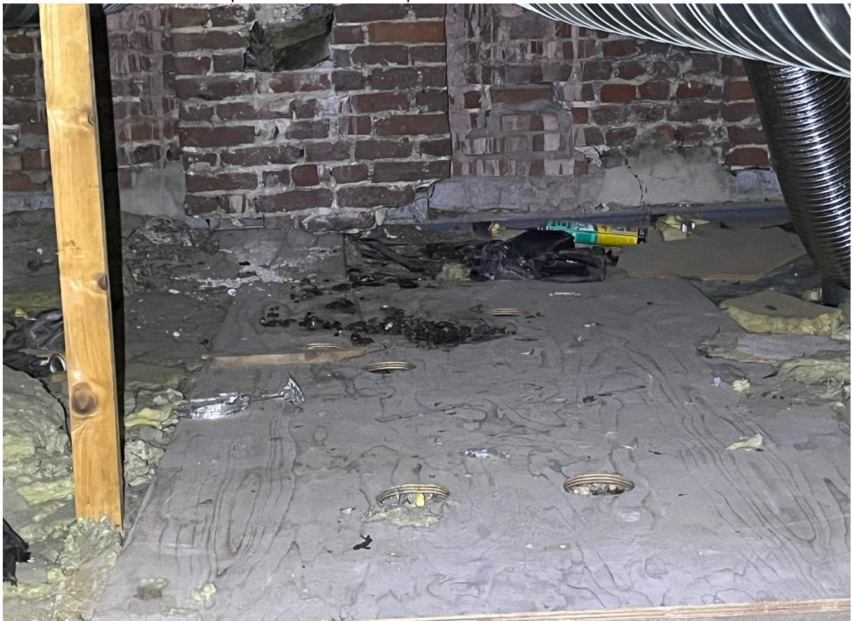
Foto 8: Steenmarterfecaliën op de zolder van het dorpshuis.
