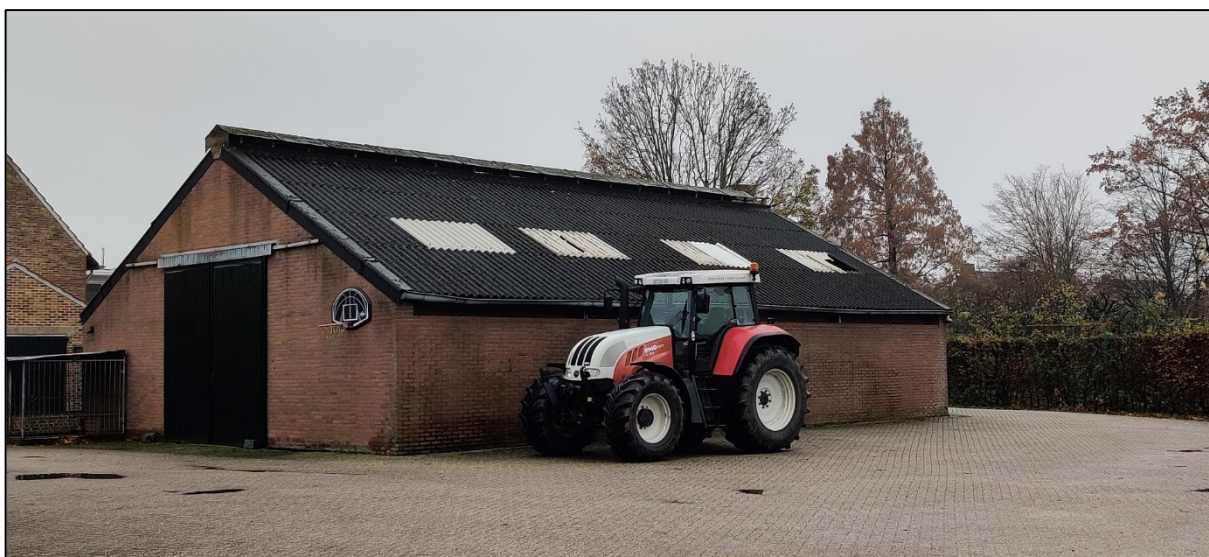
In de muren van de schuur ontbreken stootvoegen.
