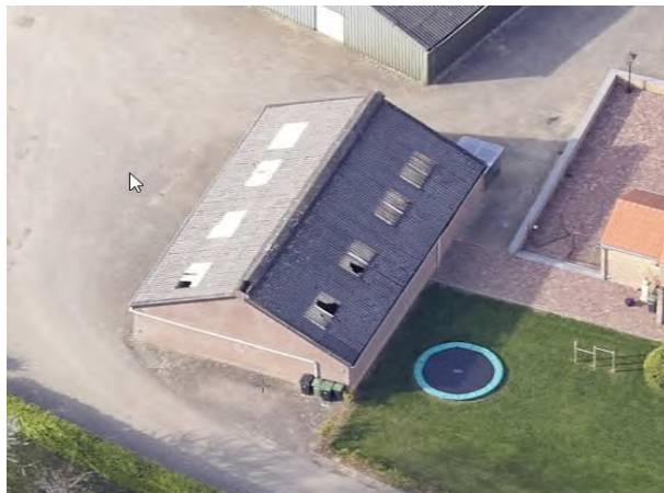
Foto 10 Schuur met asbestverdachte dakbedekking
