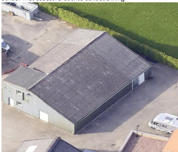
Foto 11 Schuur met asbestverdachte dakbedekking
