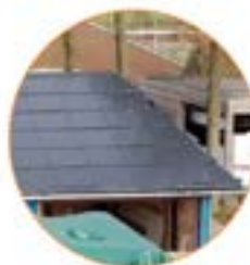
PV panelen op achterdakvlakken nieuwbouw
