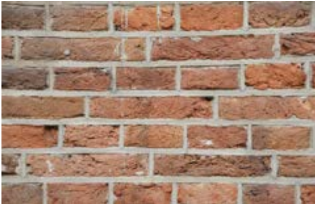
Volledig vervangen van voegwerk. Vergunning nodig.
