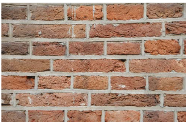
Volledig vervangen van voegwerk. Vergunning nodig.
