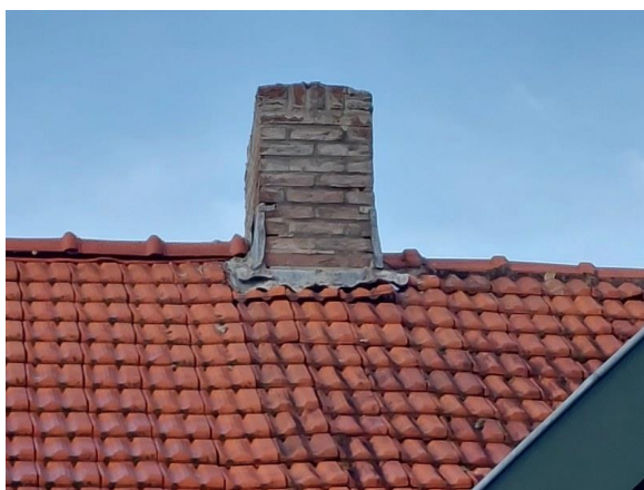
Figuur 5-4. Openingen onder dakpannen en loodslabben.
