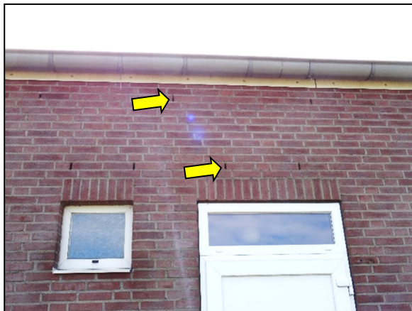
Figuur 23. Open stootvoegen (gele pijl) waar vleermuizen gebruik van kunnen maken.
