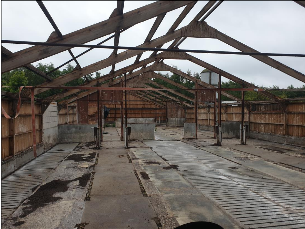
Figuur 4.2 Door sanering geen dakbedekking aanwezig.
