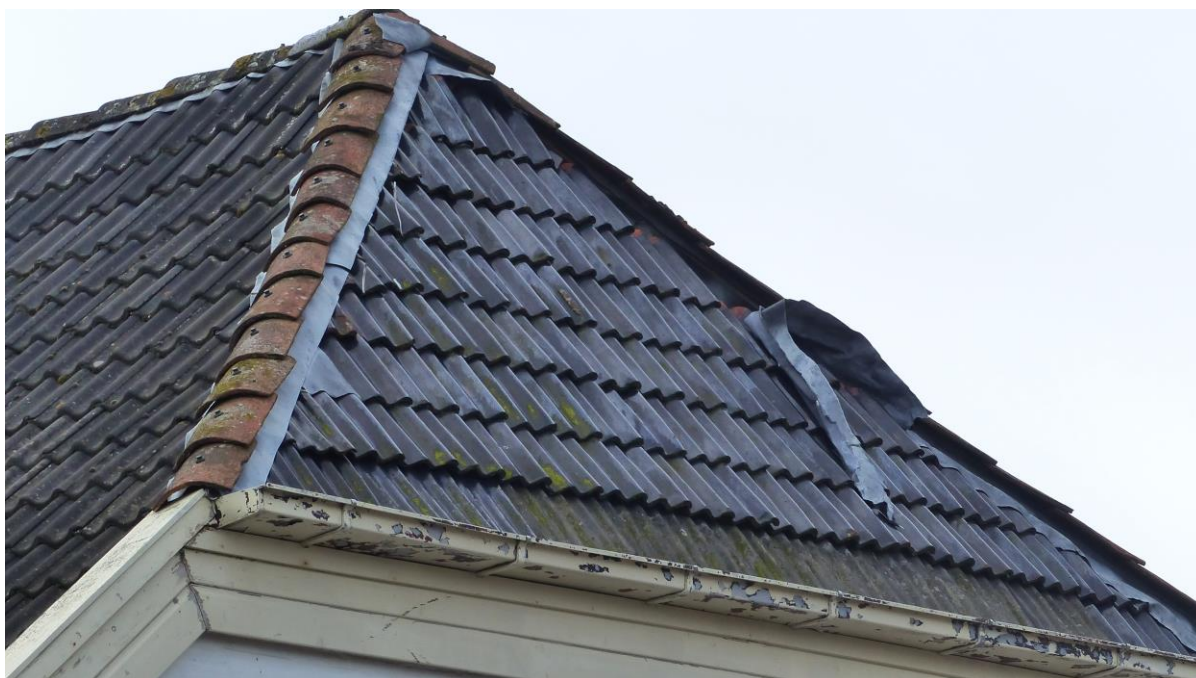
Figuur 4.3 Vleermuizen kunnen via de dakpannen toegang krijgen tot het dak.
