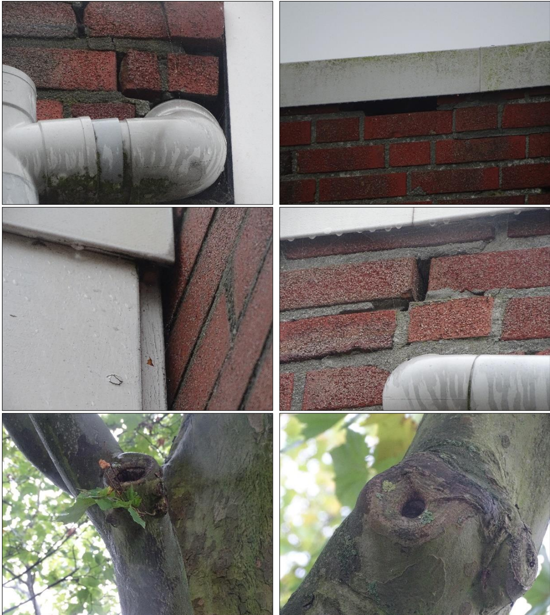
Foto's 7 t/m 12. Openingen geschikt voor vleermuizen.
