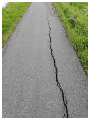
Afbeelding 2. Fietspad met gebroken asfalt
