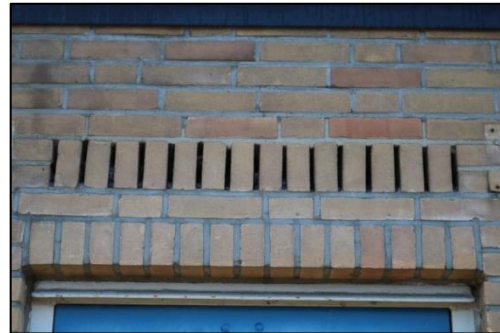
Figuur 4.16. Open stootvoegen transformatorhuisje.
