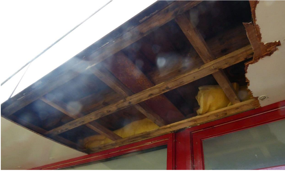
Aangetroffen gat aan de noordzijde van het schoolgebouw.
